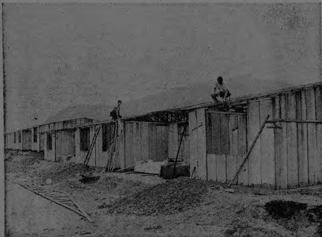
Una sección de las 575 casas con paredes Panefom que se construyen actualmente en la Urbanización el Porvenir.
