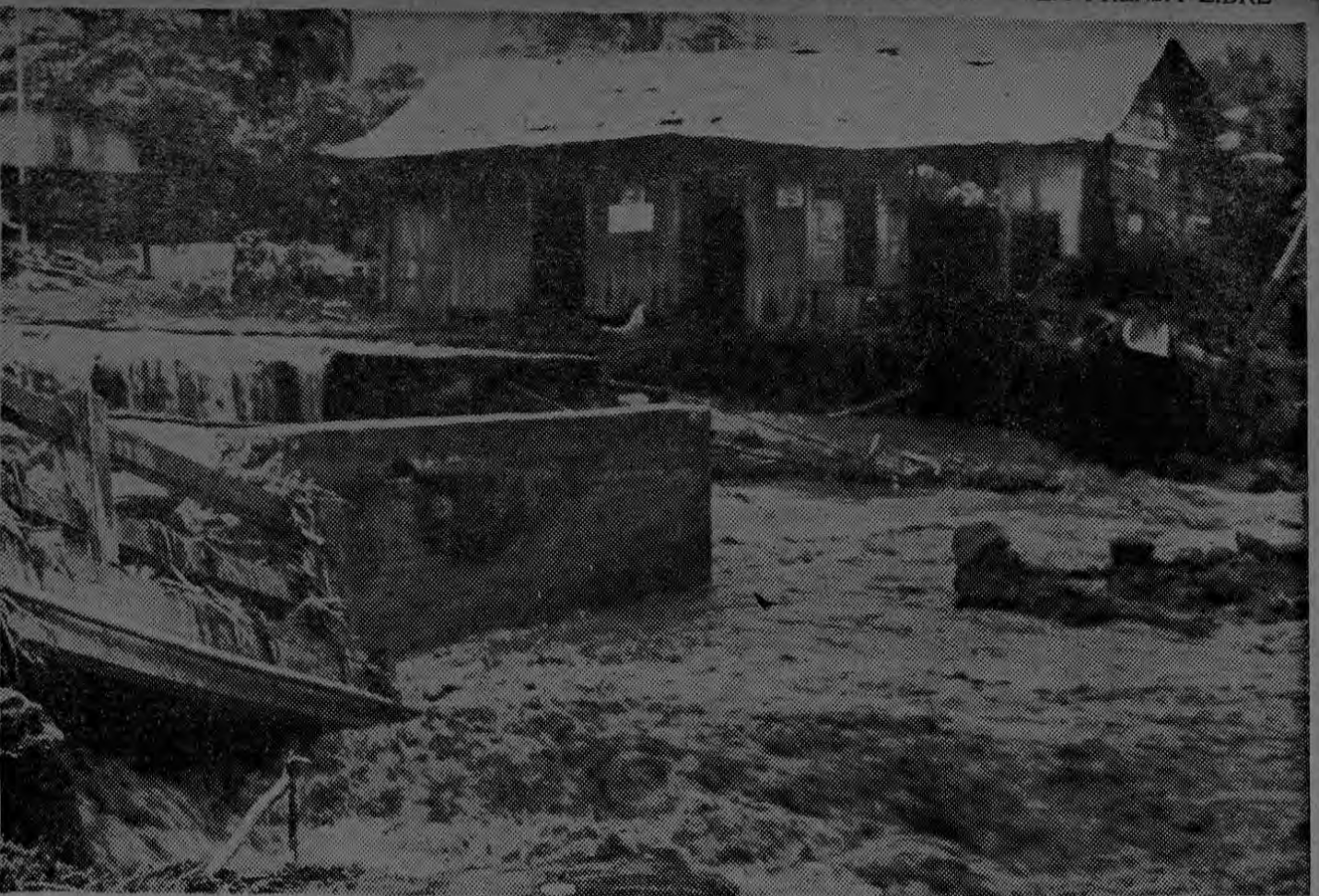
EL PUENTE a la entrada de La Suiza, en Turrialba fue arrasado ayer por la creciente del pequeño riachuelo, que ocasionó estragos como se aprecia en la gráfica, dejando así prácticamente aislada a la población. La casa que se ve, fue antes uno de los establecimientos comerciales, que fue evacuado totalmente en su mercadería. (Foto Córdoba).
